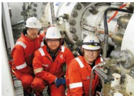
OVERHALING: Bengt Nikolaisen, Magne Hjelvik og Ole Johnny Gulseth under overhaling av kompressor på Grane-plattformen.
